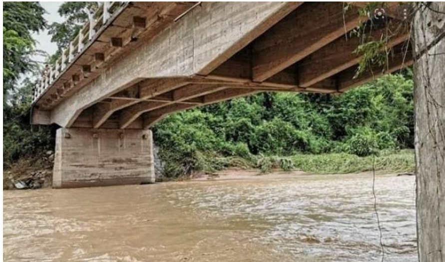
Figura 2. Imagen del puente San Telmo, con la pila izquierda colapsada.
