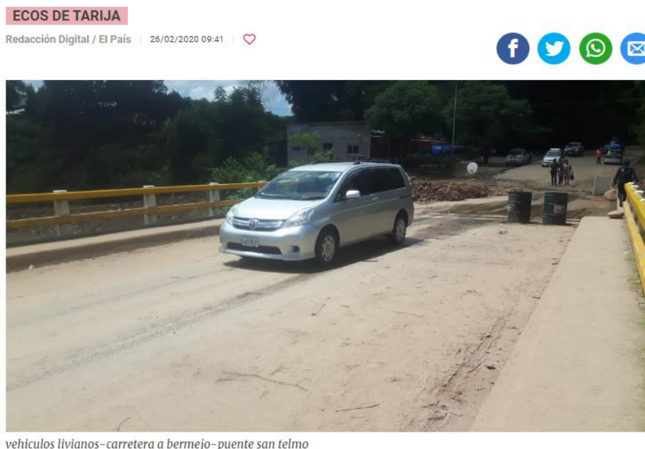
Figura 6. Habilitación del puente con la pila colapsada para la circulación de vehículos livianos.
