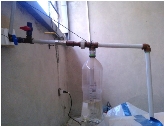
Figura 1. Conducción de biogás.
