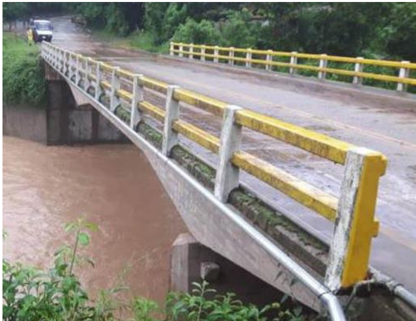
Figura 4. Puente con pila colapsada expedito para la circulación de un vehículo liviano. Fuente: periódico Los Tiempos, edición digital [24], 14-febrero-2020
