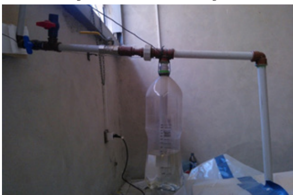
Figura 1. Conducción de biogás.
