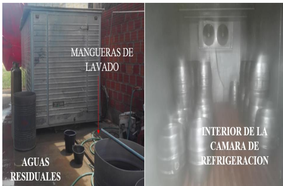
Foto III-6. Lavado de la cámara de refrigeración
