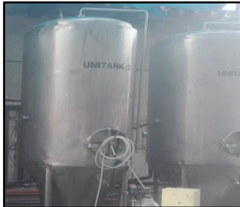
Foto II-9. Tanque de maduración
