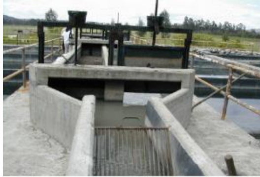
Foto IV-1. Rejilla fija con limpieza manual
