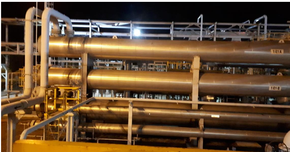
Fig. 2- 2 Intercambiador de Calor Gas/Gas
