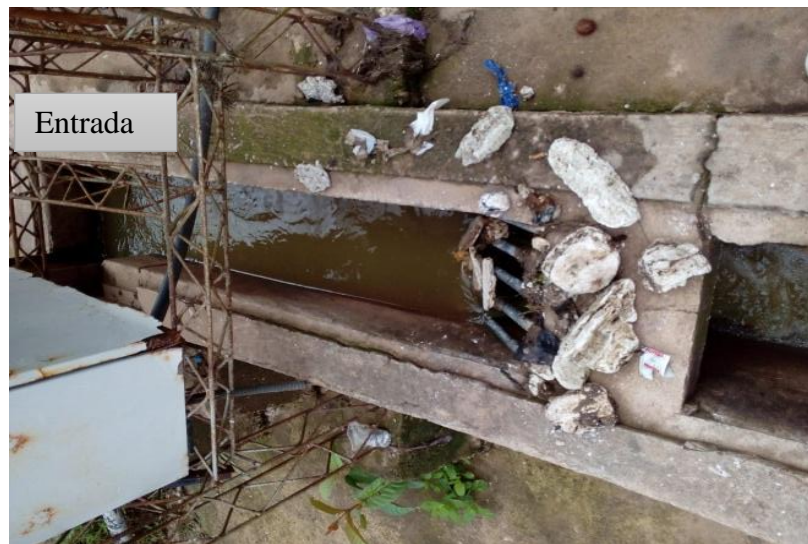
Foto 2-19. Canal de entrada de Aguas Residuales a la PTAR. Elaboración Propia
