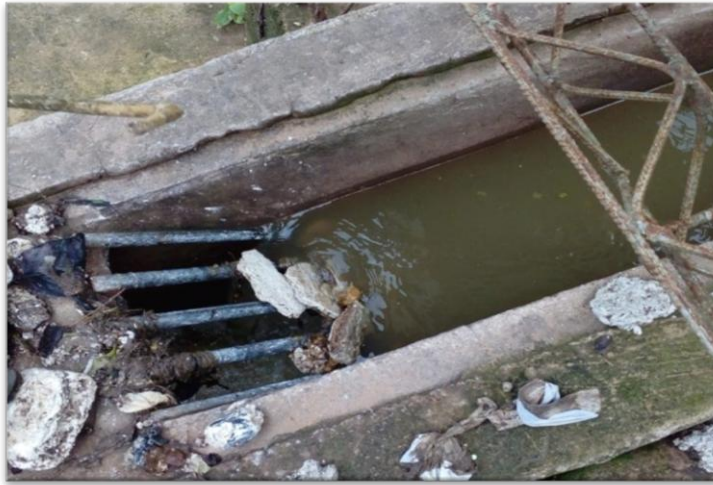
Foto 2-3. Rejillas gruesas con presencia de gran cantidad de sólidos. Elaboración Propia
