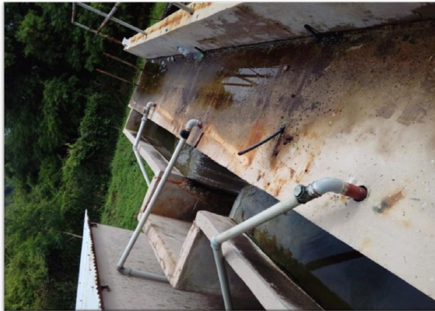
Foto 2-10. Tuberías para introducir aire al Tanque de Aireación. Elaboración Propia
