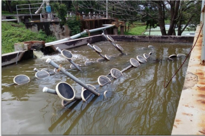
Foto 2-9. Superficie del Tanque de Aireación. Elaboración Propia
