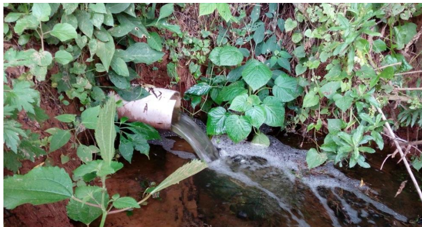
Foto 2-21. Descarga de la PTAR. Elaboración Propia
