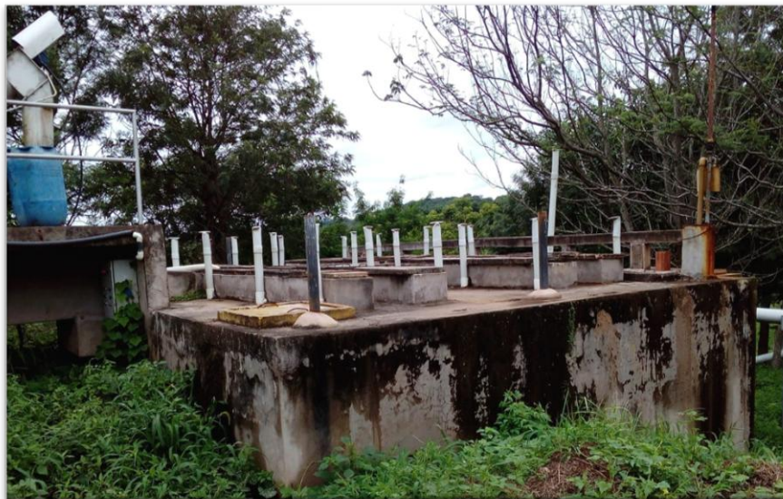
Foto 2-8. Vista Externa del Reactor UASB. Elaboración Propia
