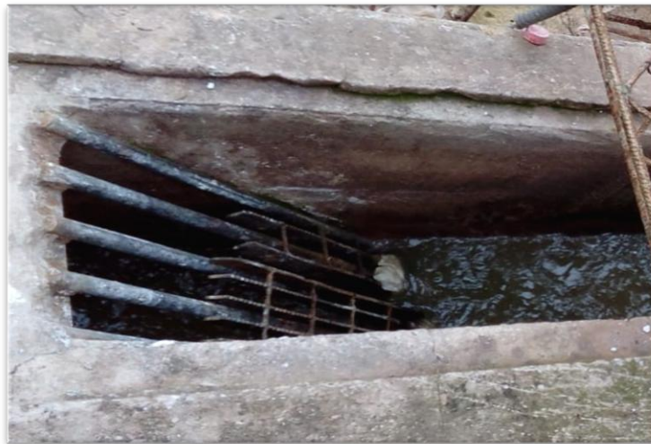
Foto 2-4. Rejillas gruesas y delgadas. Elaboración Propia
