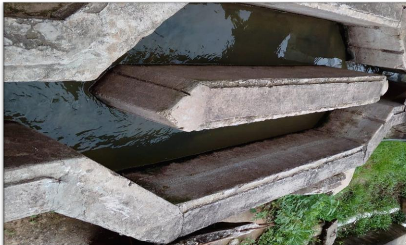
Foto 2-5. Desarenador. Elaboración Propia
