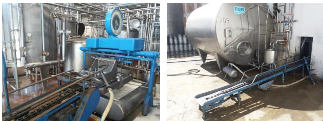
Figura 2-11. Instalaciones de Recepción de Leche Cruda en PIL Tarija S.A
