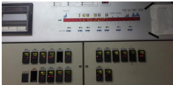
Foto N° 14 Tablero de control de temperatura del horno
