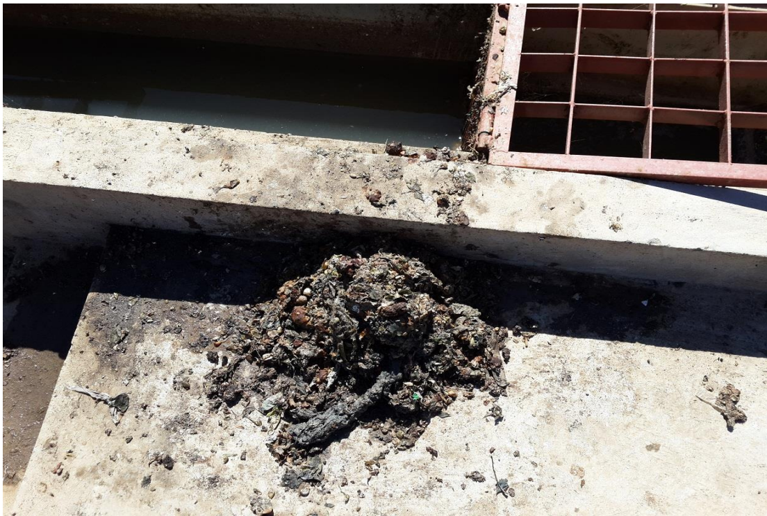
Figura 4-2 Semisólidos provenientes del tanque sedimentador
