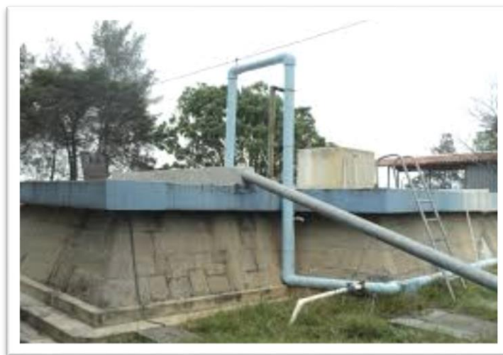
Figura II-8 Tanque de Agua enterrado
