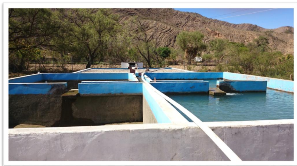
Fig. II-5 Filtros de arena
