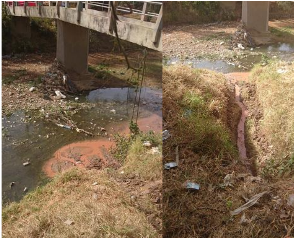
Figura 32. Descargas de aguas a la Quebrada El Monte gestión 2016
