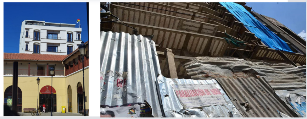
Figura 2: Construcción fuera de norma dentro del Centro histórico
