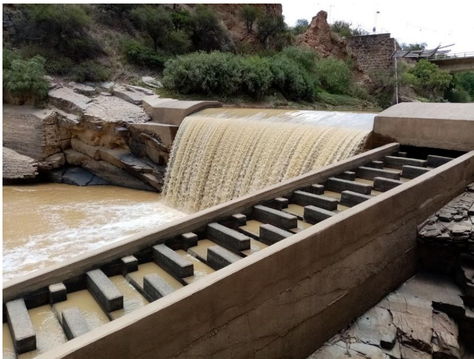
Fotografía 1 Vista aguas debajo de la obra de toma del proyecto de riego Guadalquivir-CENAVIT-Calamuchita
