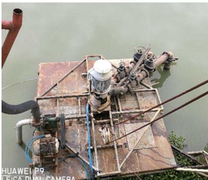
Fotografía 5. Plataforma flotante de bombeo.
